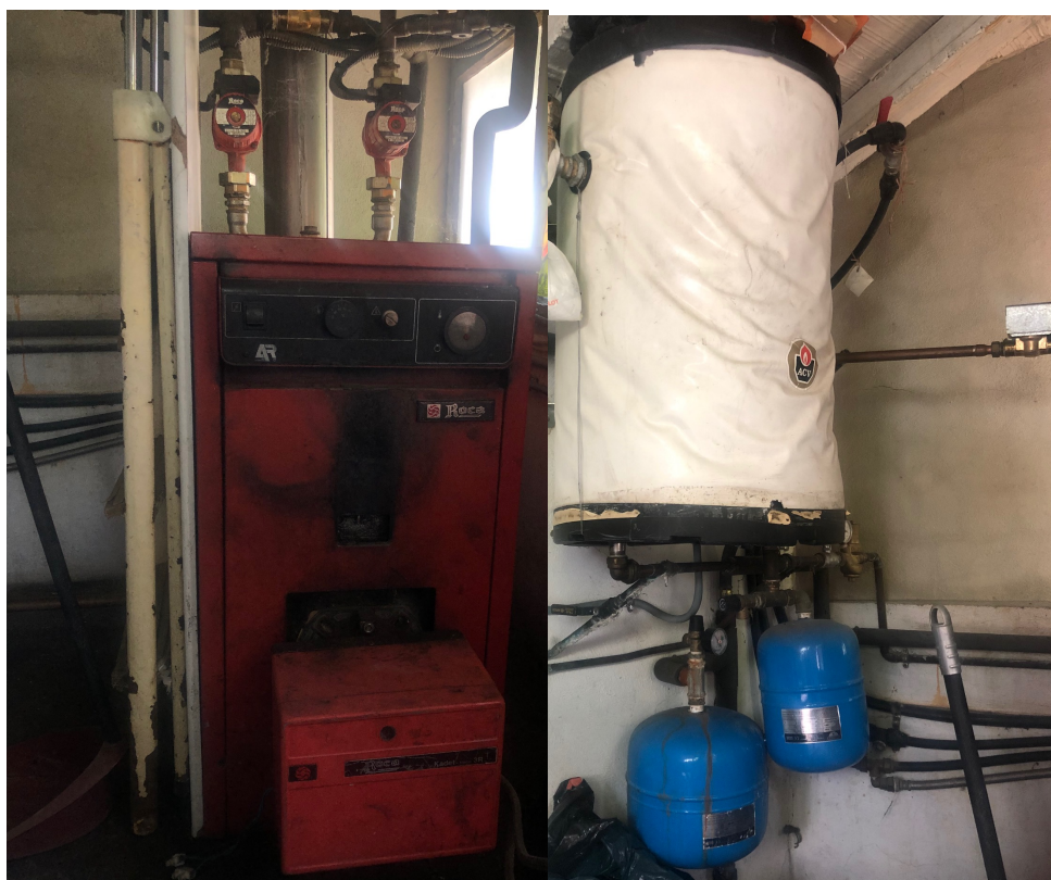
Figura 7. Caldera de gasoil i acumulador d'ACS
