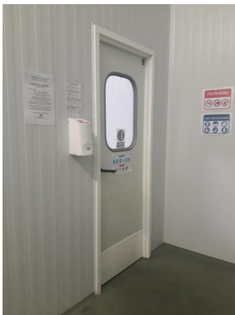
Figura 29. Entrada a planta de fabricació. S'observa la manca d'un pas sanitari que obligui al desinfectat de mans.
