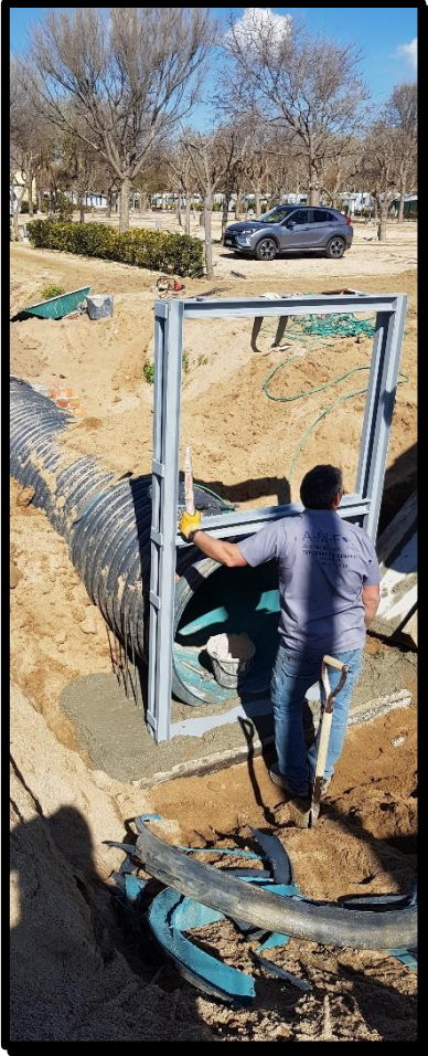
Fotografía 10 Obras de canalización del agua en el Rec Viver. Año 2018. Fuente: HL.
