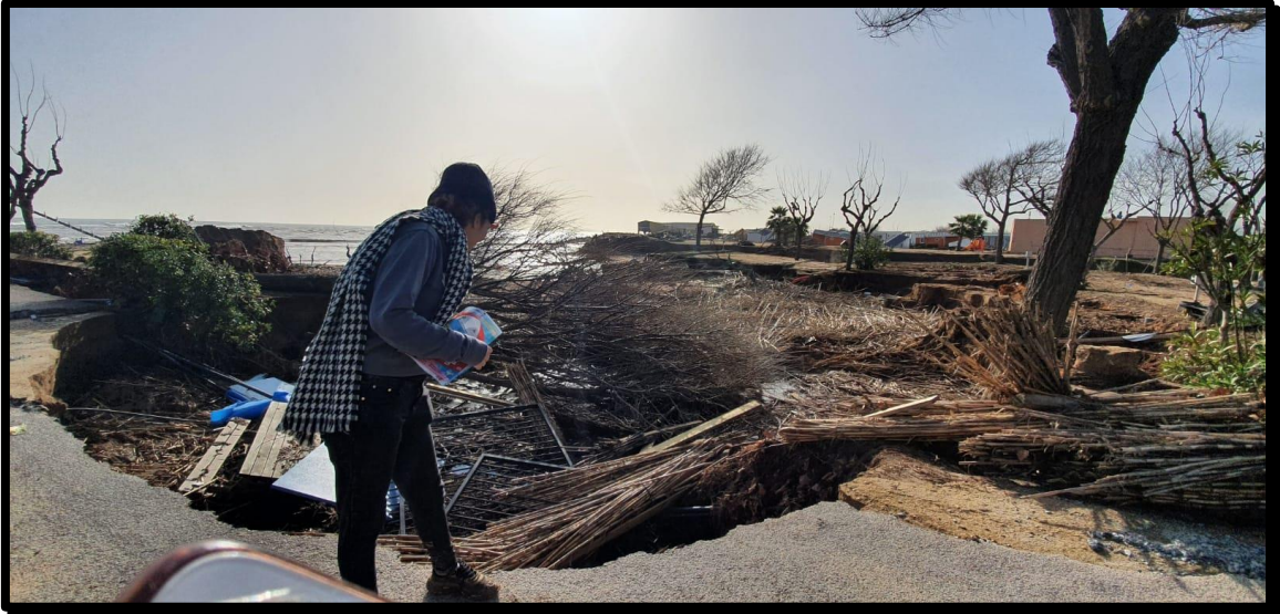
Fotografía 20 Socavón en el interior del camping provocado por el temporal. Zona de parcelas Camping La Tordera. Fuente: Archivo personal Patricia Pérez
