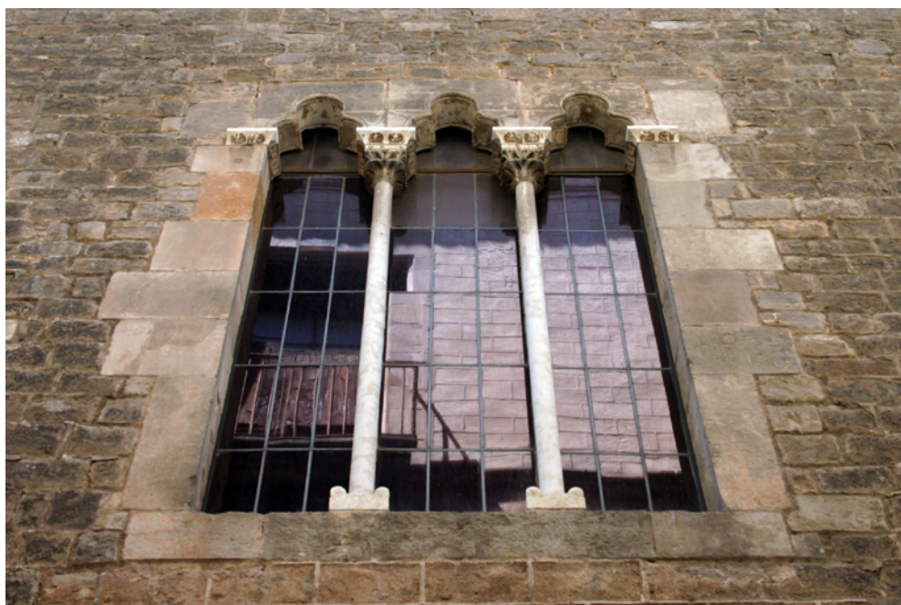
Figura 10. Finestra trifora o de mainell amb llindes lobulars de pedra de Montjuïc. Tenen unes cronologies genèricament gòtiques, per bé que el model de la imatge (tot i que restaurat en els capitells, els mainells i les bases) seria del segle xv, tal com podem observar pel relleu del bordó de l'interior dels lòbuls. Finestra del primer pis de la finca número 12 del carrer Montcada: Casal del Marquès de Llió, actual Museu de Cultures del Món de Barcelona. Font: Reinald González (Veclus).
