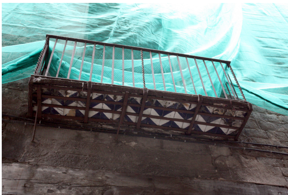
Figura 20. Detall d'un balcó barroc amb una volada suportada per perfils de ferro forjat en forma d'ela que es claven a la façana. Podem distingir les rajoles de cartabó de la contrasolera —blau i blanc— i els barrots helicoidals de la barana. Finca número 7 del carrer Lledó de Barcelona, segle XVIII. Font: Reinald González i Helena Morán (Veclus).
