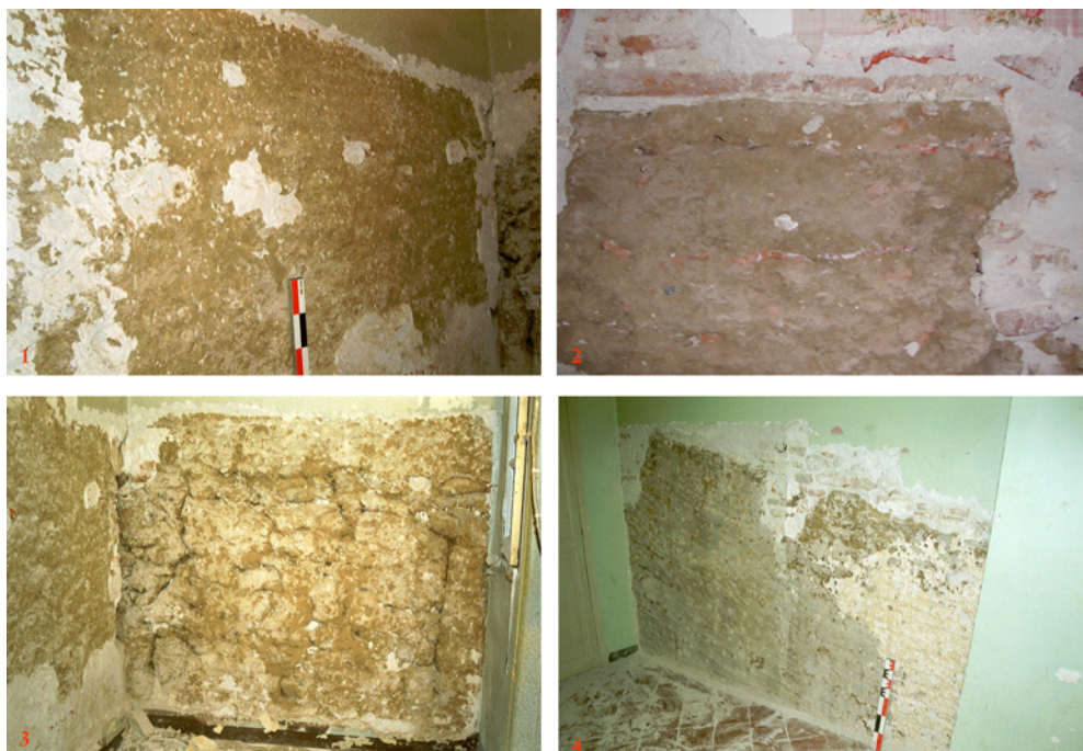
Figure 5 : La mise en œuvre de la terre massive : pisé (1), bauge en lits filants séparés par des lits de tuiles courbes (2), bauge sous forme de pains roulés dans des végétaux (3) employée pour des réparations ponctuelles, et bauge coffrée (4) (crédit : I. Rémy, C. Fock-Chow-Tho, Cl.-A ; de Chazelles).
