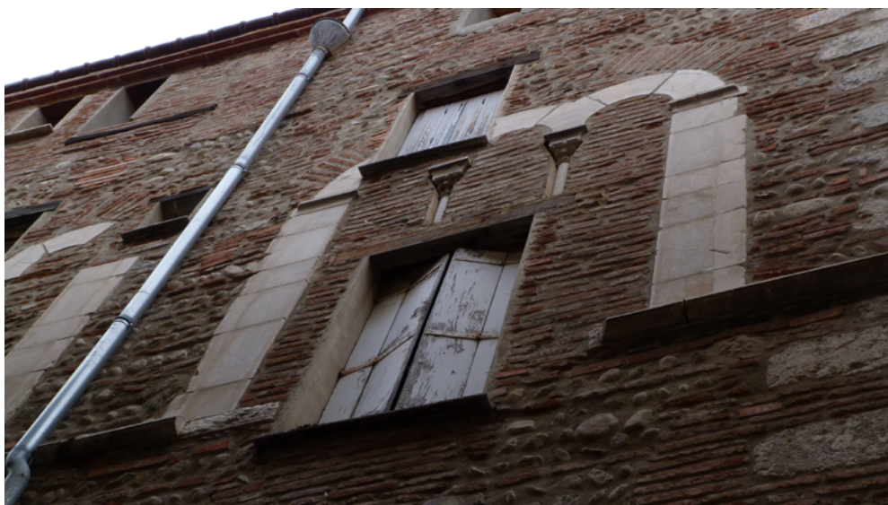
Figure 1. Perpignan, rue Voltaire. Matériaux multiples, galets, carreaux, pierre de taille. Baie triple sous arcs plein-cintre. Cl. G. Bellan
