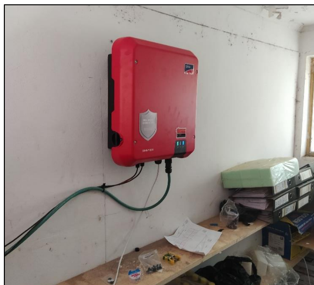
Figura 9. Fotografia de l'inversor instal·lat a l'escola d'Abay Mado.
