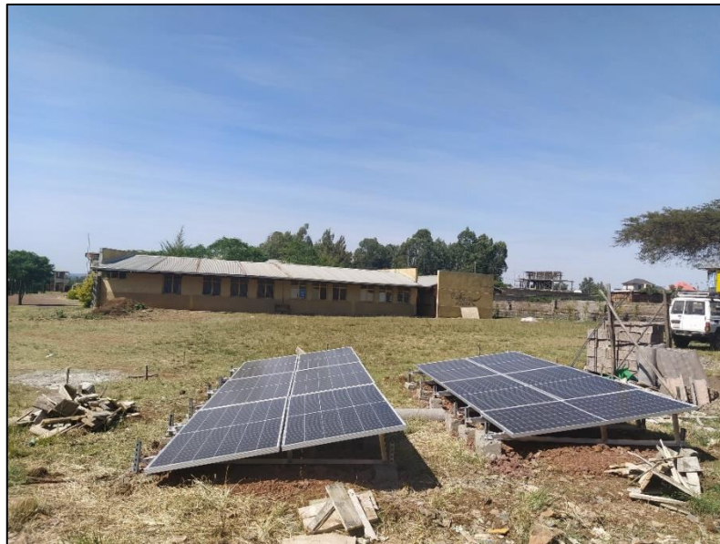
Figura 7. Fotografia dels panells instal·lats a l'escola d'Abay Mado.
