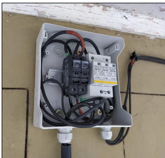
Figura 11. Fotografia de la caixa de proteccions de CC de la instal·lació de l'escola d'Abay Mado.
