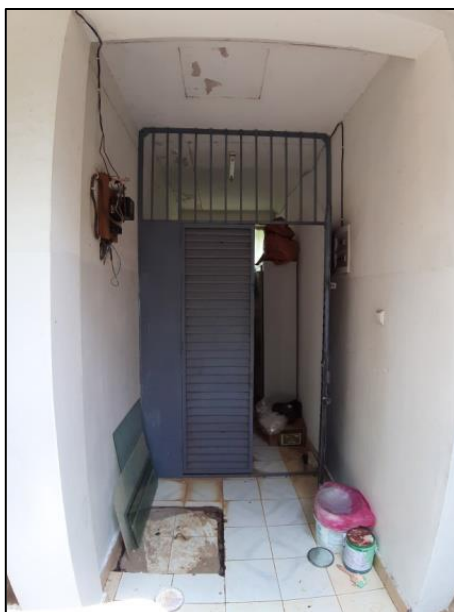
Figura 8. Sala a on està ubicat l'inversor.
