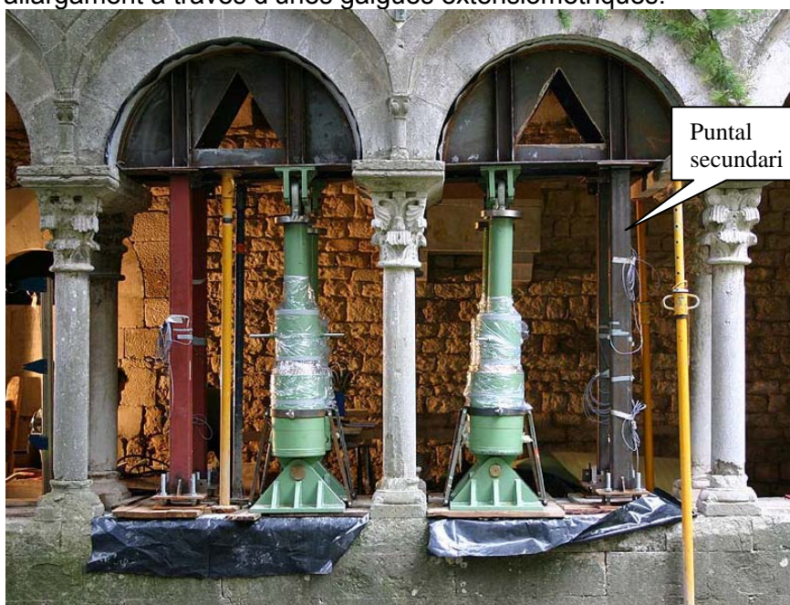
Fig. D.1. Vista general del muntatge.
