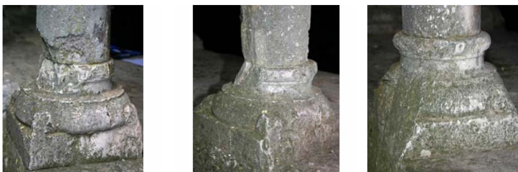
Fig. 81. Estat d'algunes de les columnes del claustre de la catedral de Girona. columna 1, columna 3 i columna 5
