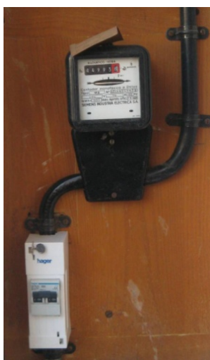
Imatge 1: Vista dels dispositius de control i mesura de la instal·lació elèctrica en l'estat actual.
