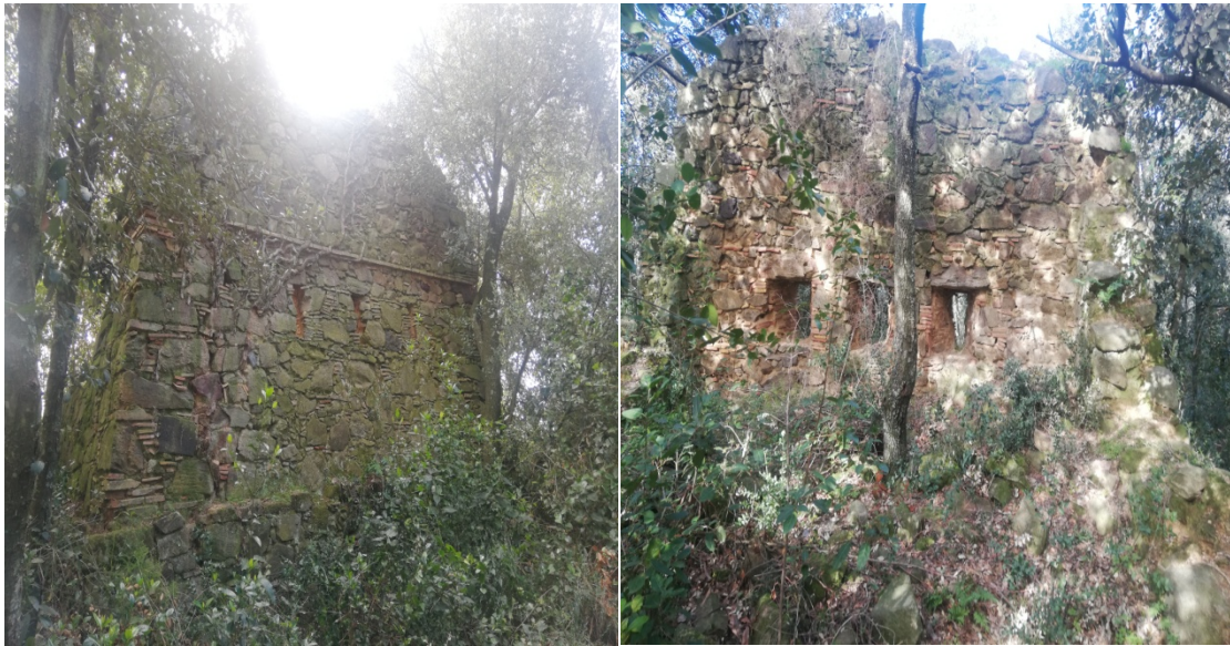
Foto 1 (esquerra): Paret nord-oest, la única que es conserva en peu de la torre, tot i que i veiem vegetació. Fotografia presa el dia 1/2/2020.
