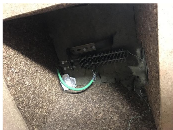
Imatge 34. Interior de cambra calenta on s'observa la resistència i el termopad. Font: pròpia
