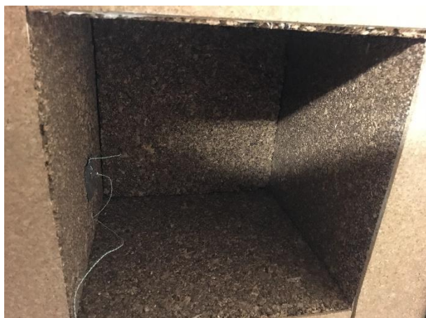
Imatge 35 Interior de cambra freda on s'observa el termopad. Font: pròpia
