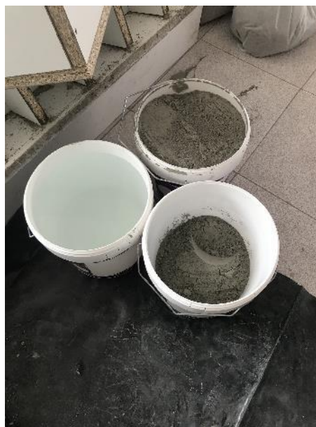
Imatge 57. Cubells per el ciment i l'aigua per mantenir la relació aigua ciment constant. Font: pròpia
