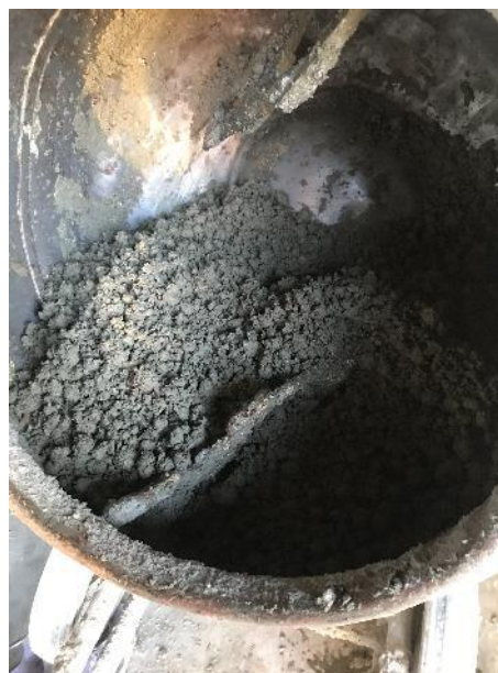
Imatge 70. Massa resultant després de l'addició de la fibra total, el ciment i l'aigua per no perdre la relació d'aigua-ciment.
