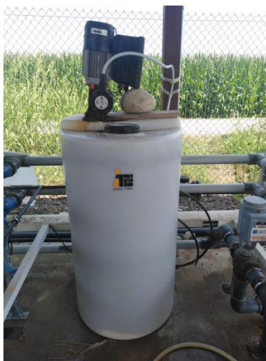
Figura 19. Equip d'injecció de clor i dipòsit.
