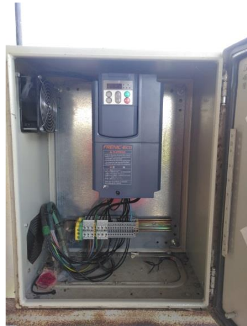
Figura 15. Variador de freqüència.
