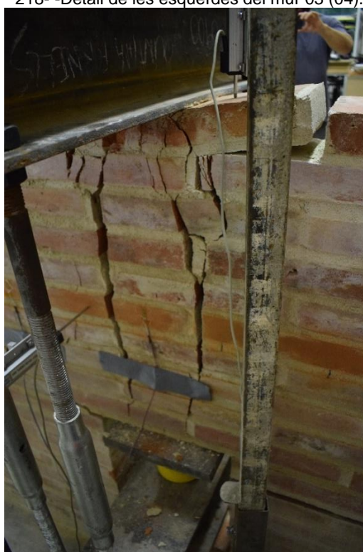
Imatges 219. Detall de les esquerdes del mur 03 (03).
