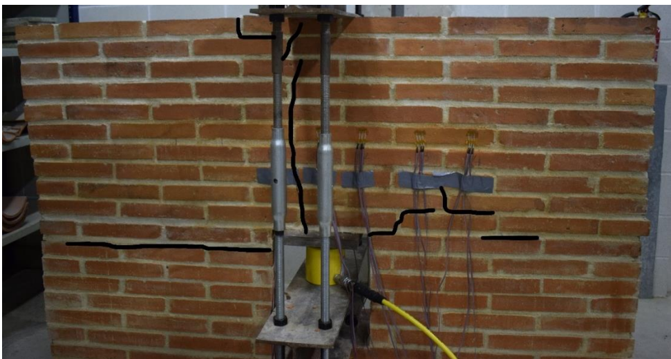
Imatge 210. Remarcat de les esquerdes que sorgeixen el mur 03 (02).
