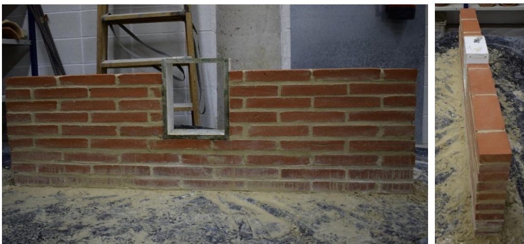
Imatges 071 i 072. 071- Construcció de la base del mur 03, fase 1 (04). 072- Construcció de la base del mur 03, fase 1 (05).
