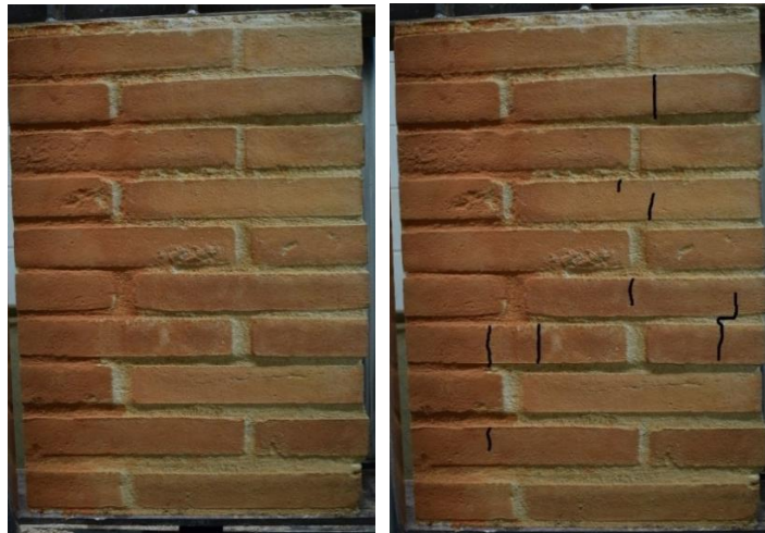
Imatges 140 i 141. 140- Seguiment de les esquerdes que sorgeixen a la proveta d'obra de fàbrica 02. 141- Remarcat de les esquerdes que sorgeixen a la proveta d'obra de fàbrica 02.
