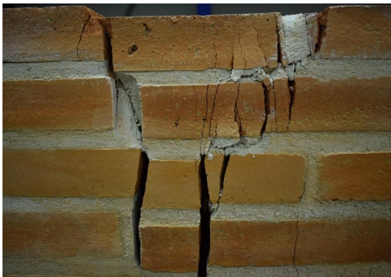
Imatge 177. Detall de les esquerdes el mur 02.
