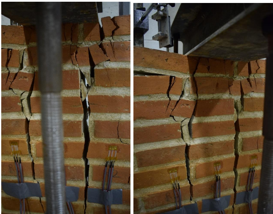
Imatges 217 i 218. 217-Detall de les esquerdes del mur 03 (03). 218- -Detall de les esquerdes del mur 03 (04).
