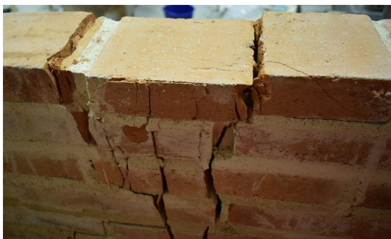
Imatge 178. Detall de les esquerdes en la cara posterior del mur 02.
