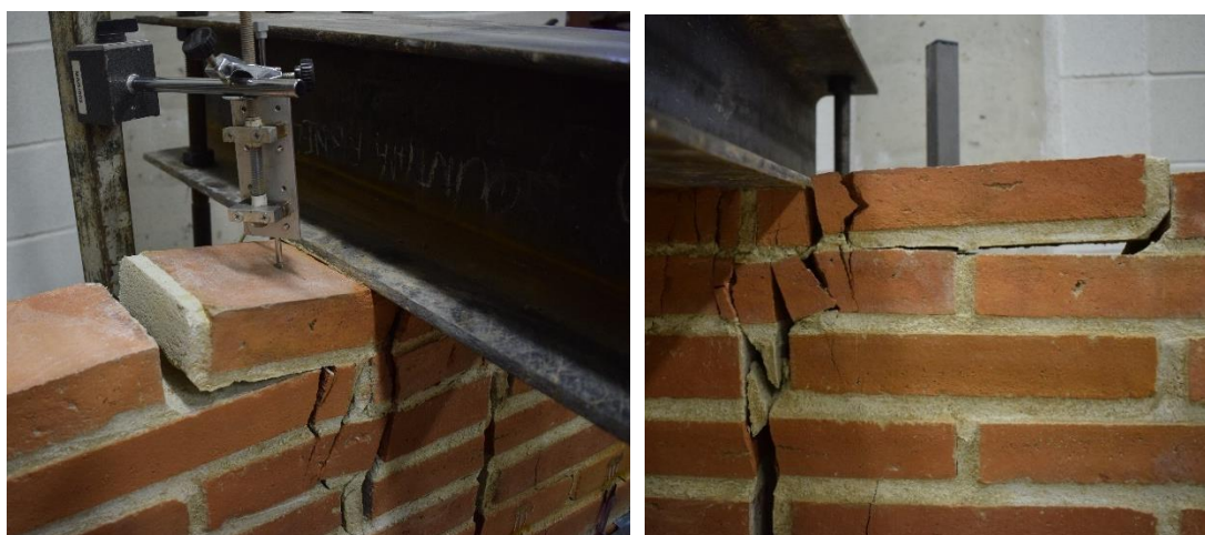
Imatges 215 i 216. 215- Detall de les esquerdes del mur 03 (01). 2116- Detall de les esquerdes del mur 03 (02).
