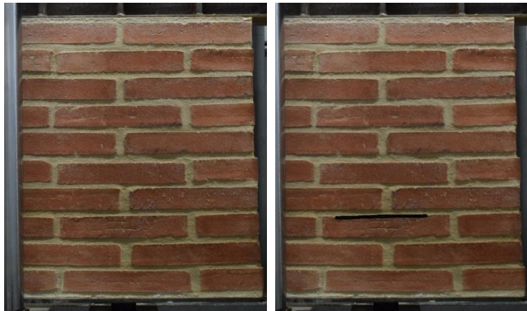
Imatges 123 i 124. 123- Seguiment de les esquerdes que proveta d'obra de fàbrica 01 (01). 124- Remarcat de les esquerdes que sorgeixen a la proveta d'obra de fàbrica (01).
