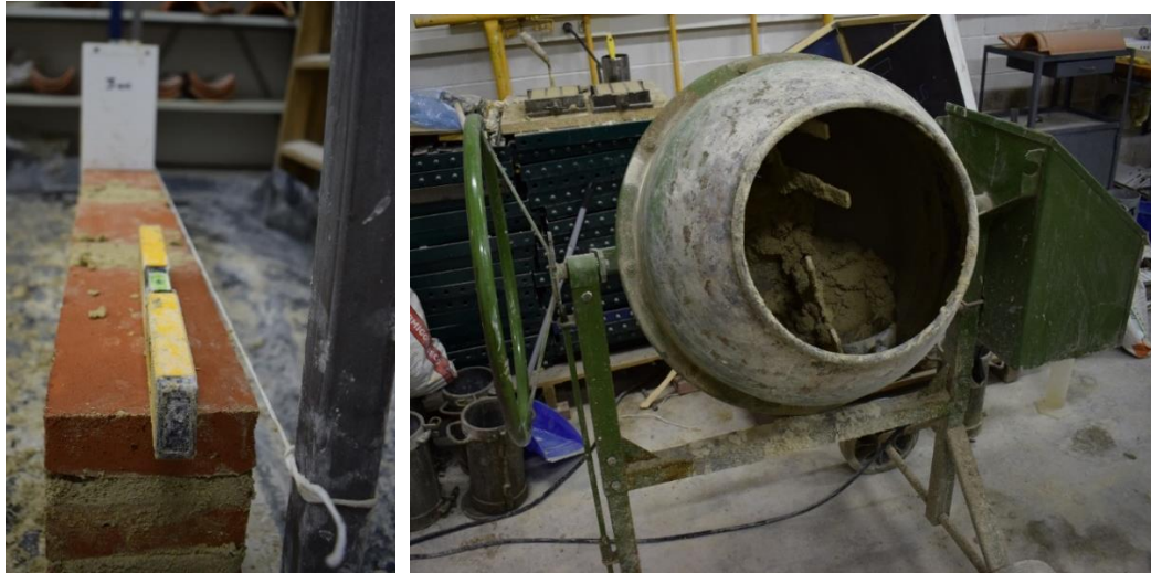
Imatges 068 i 069. 068- Comprovació de l'anivellació del mur a l'hora de col·locar les peces. 069- Utilització de la formigonera per elaborar el morter de calç.
