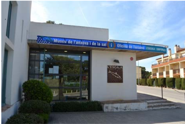
Fig. 6.8.2. Policarbonat cobrint cornisa de formigó vist. Font: Pròpia
