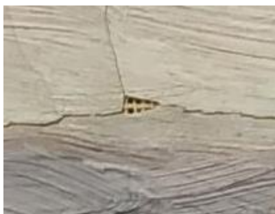
Imatge 58: Díaz i Costa, Eusebi. Detall d'un despreniment en l'obra Palamós (c. 1940-1947).
