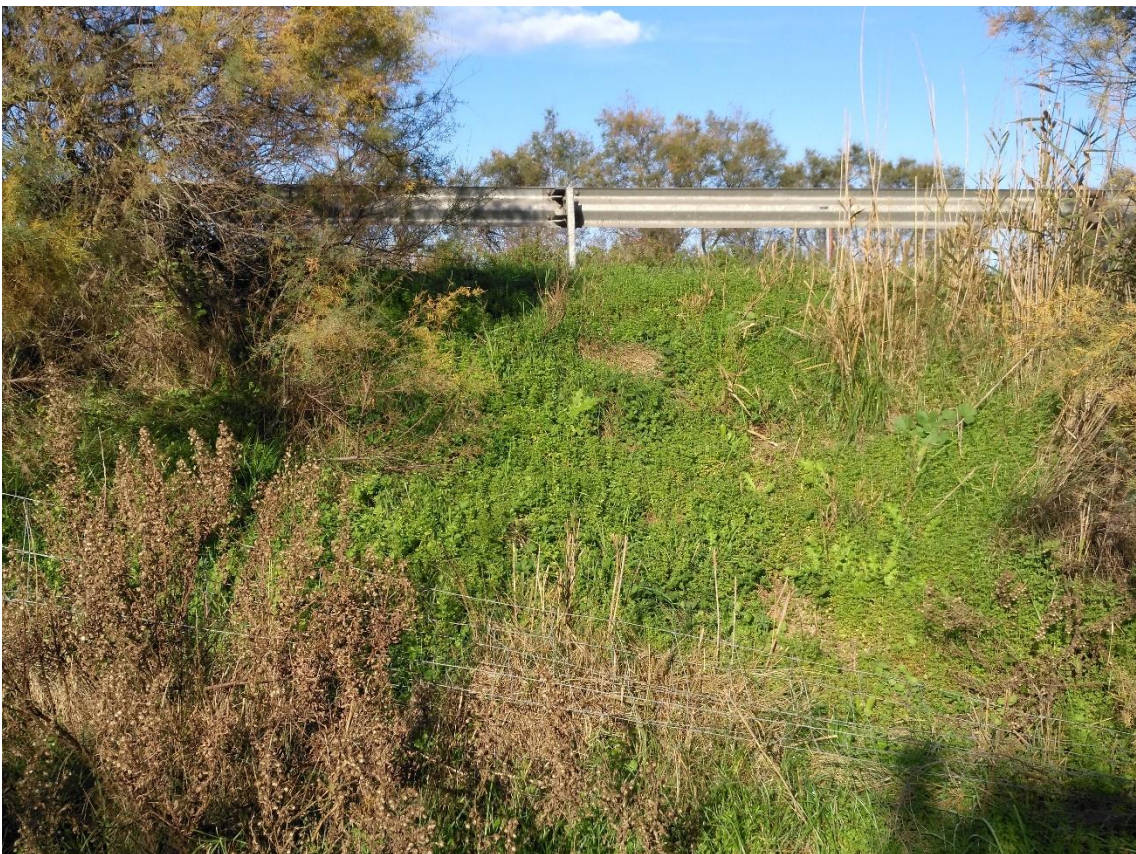
Figura 52. Tanca perimetral en mal estat. En aquesta fotografia s'observa com una part de la tanca perimetral de la bateria de passos fauna del tram de la C-68 que travessa el polígon nord està vençuda. Sense l'adequat manteniment d'aquestes estructures pot haver-hi un augment de l'accidentalitat amb animals, ja que els ungulats poden passar fàcilment per sobre d'aquestes tanques i travessar la carretera: Autor: Daniel Bejarano Leandro.
