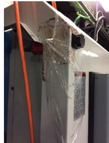
Fotografía 11: El enclavamiento ponteado
