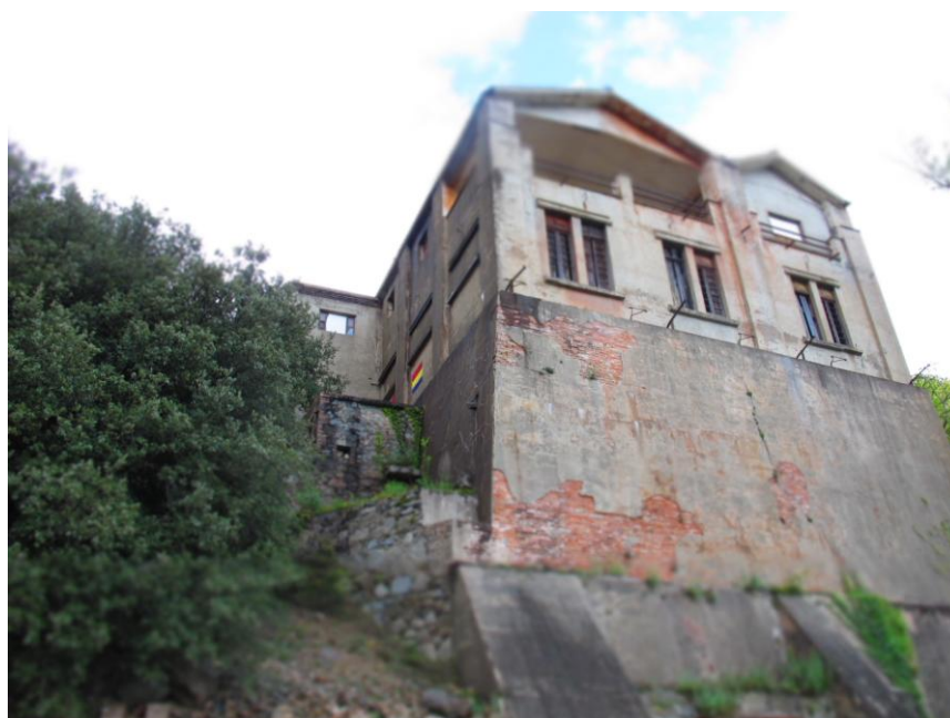
Imatge 27: Vista frontal de l'edifici de la mina Canta (2016). Font: Elaboració pròpia
