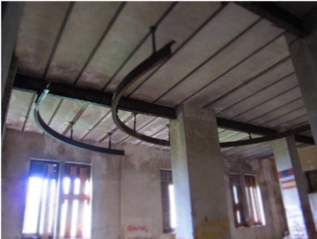
Annex 2. Rails per a transportar les caixes dels camions fins als muntacàrregues (2016). Font: Elaboració pròpia.
