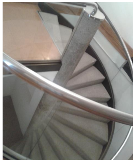
Escala de cargol no accessible. Any 2016. Font pròpia
