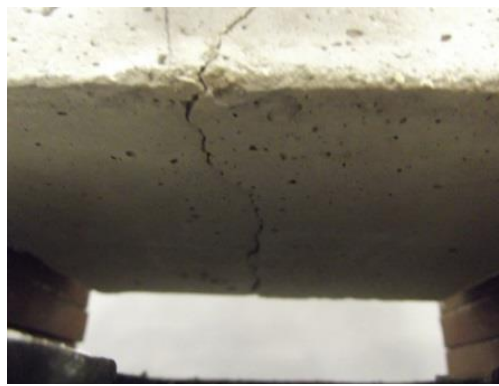
Il·lustració 5.20. Interpretació falla formigó PT3.03
