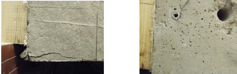
Il·lustració 5.8. Interpretació falla formigó PT4.03
