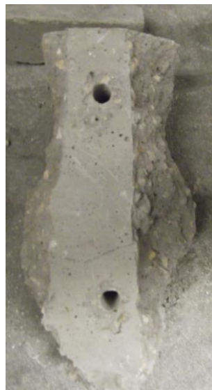
Il·lustració 5.9. Interpretació falla formigó PT4.03
