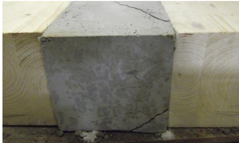
Il·lustració 5.27. Interpretació falla formigó PT2.02
