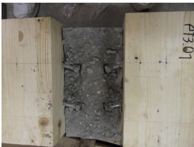
Il·lustració 5.12. Interpretació falla formigó PT3.01
