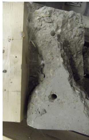
Il·lustració 5.38. Interpretació falla formigó PT1.02
