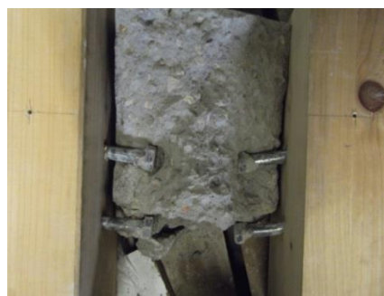
Il·lustració 5.31. Interpretació falla formigó PT2.03
