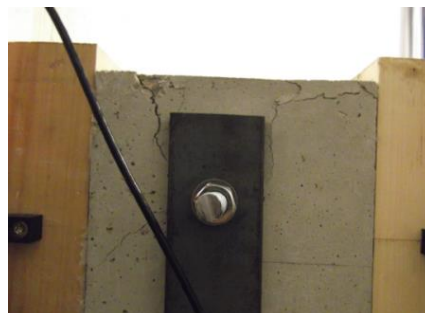
Il·lustració 5.33. Interpretació falla formigó PT1.01
