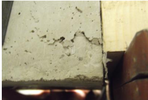
Il·lustració 5.34. Interpretació falla formigó PT1.01
