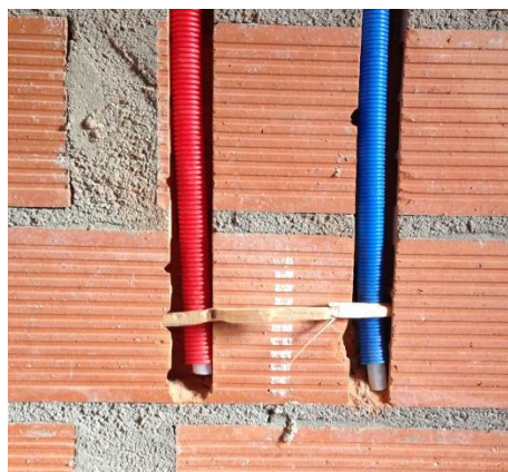
Figura 18: Pas d'instal·lacions en sistemes ceràmics
