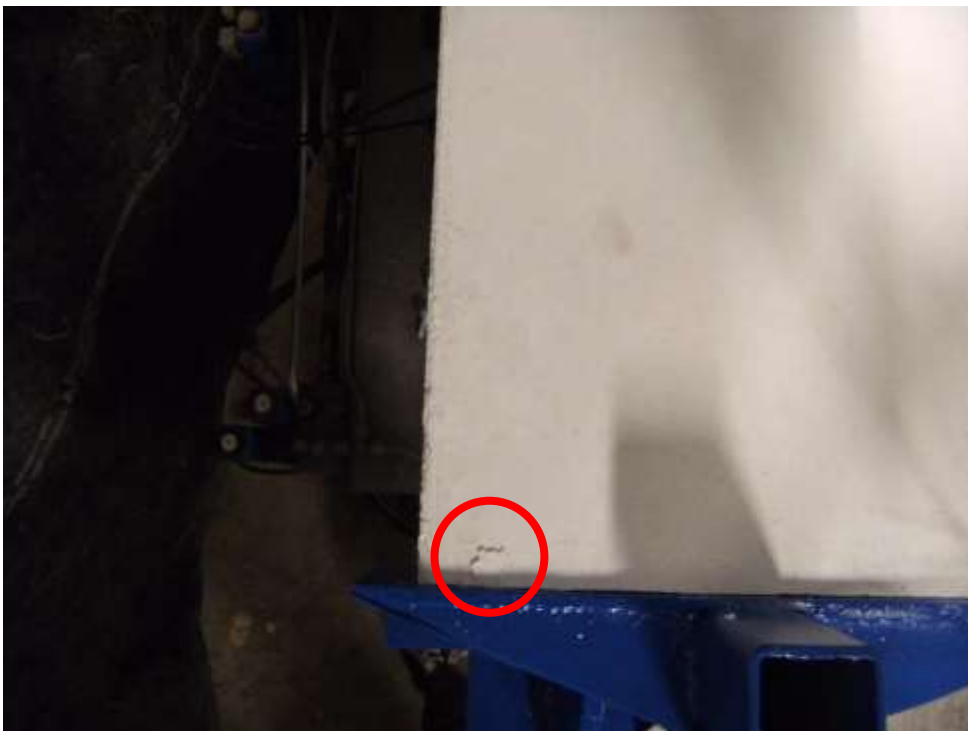
Figura 5.10.3.4c – Fissura laminar (vista 3)
