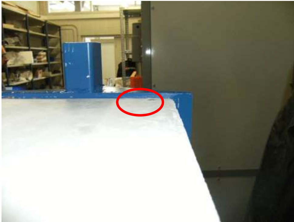
Figura 5.10.3.4b – Fissura laminar (vista 2)
