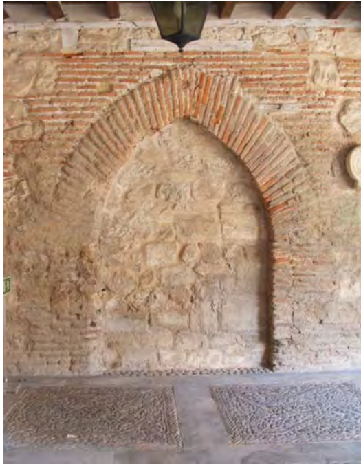
Fig. 36.- Las Huelgas. Claustro de Las Claustillas. Detalle de una de las puertas obliteradas de la panda este
