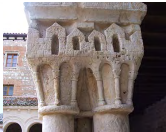
Fig. 57.- Las Huelgas. Claustro de Las Claustrillas. Doble capital del lado sur del machón central de la panda oriental
