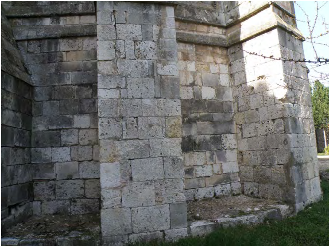
Fig. 209.- Las Huelgas. Iglesia abacial. Los dos primeros contrafuertes del arranque meridional del heptágono absidal, cuyos sillares no se corresponden con las hiladas de los muros de los paños
