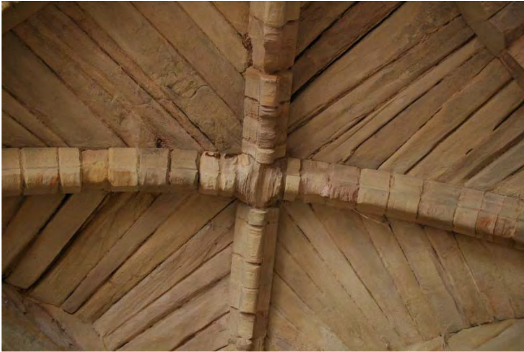
Fig. 186.- Monasterio de Moreruela. Sala capitular. Detalle de la plementería de una de sus bóvedas cuatrimpartitas
