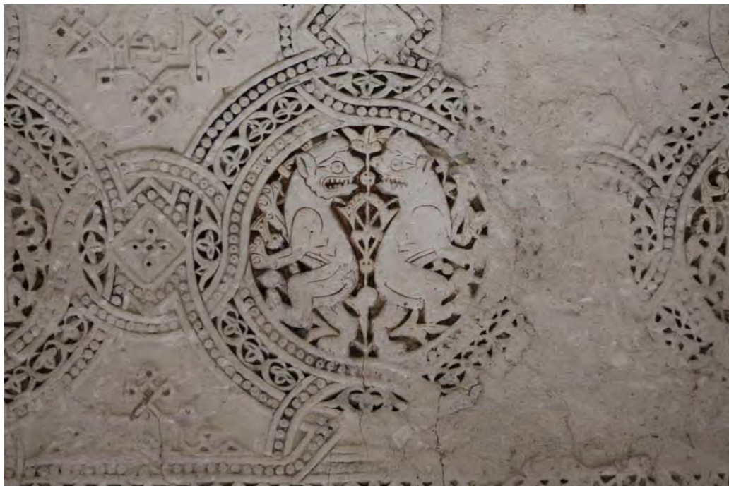
Fig. 614.- Las Huelgas. Claustro de San Fernando. Detalle de uno de los círculos con bestias de las yeserías del sexto tramo (desde el este) de la panda meridional
