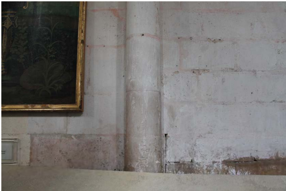
Fig. 367.- Las Huelgas. Iglesia abacial. Salto de hiladas producido en la confluencia entre el segundo y el tercer tramo (desde el este) de la nave norte
