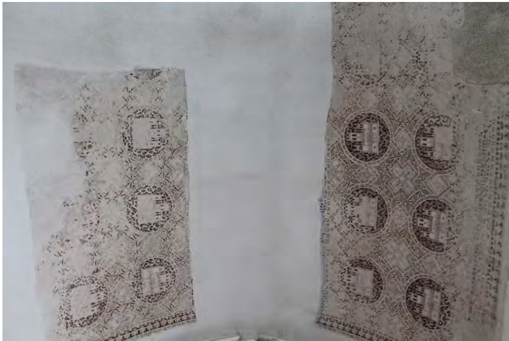
Fig. 607.- Las Huelgas. Claustro de San Fernando. Yeserías del segundo tramo (desde el este) de la galería meridional
