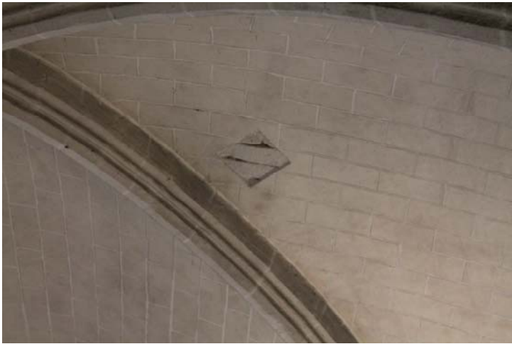
Fig. 375.- Las Huelgas. Iglesia abacial. Desconchón provocado por una cata (2002) en el enlucido de una de las bóvedas de la nave sur y plementería original
