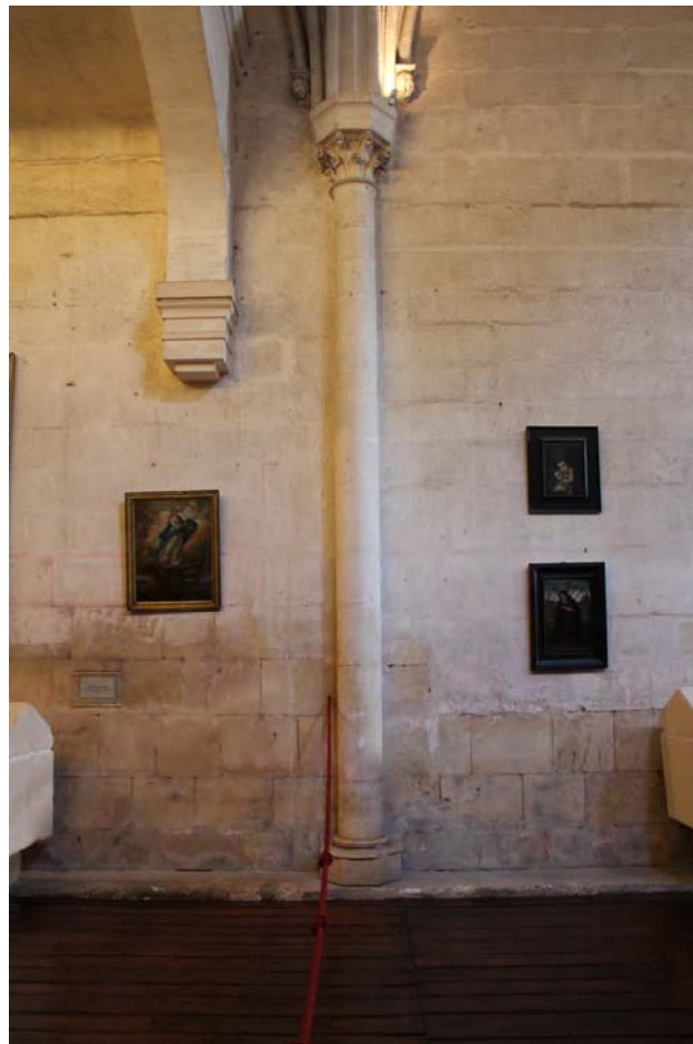
Fig. 392.- Las Huelgas. Iglesia abacial. Persistente desajuste de hiladas producido junto a la columna que separa el segundo y el tercer tramos (desde el este) de la nave meridional
