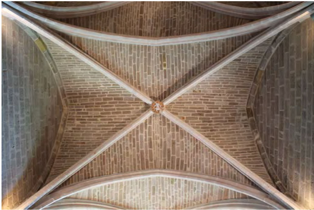
Fig. 849.- Las Huelgas. Capilla de San Juan. Una de sus bóvedas de crucería
