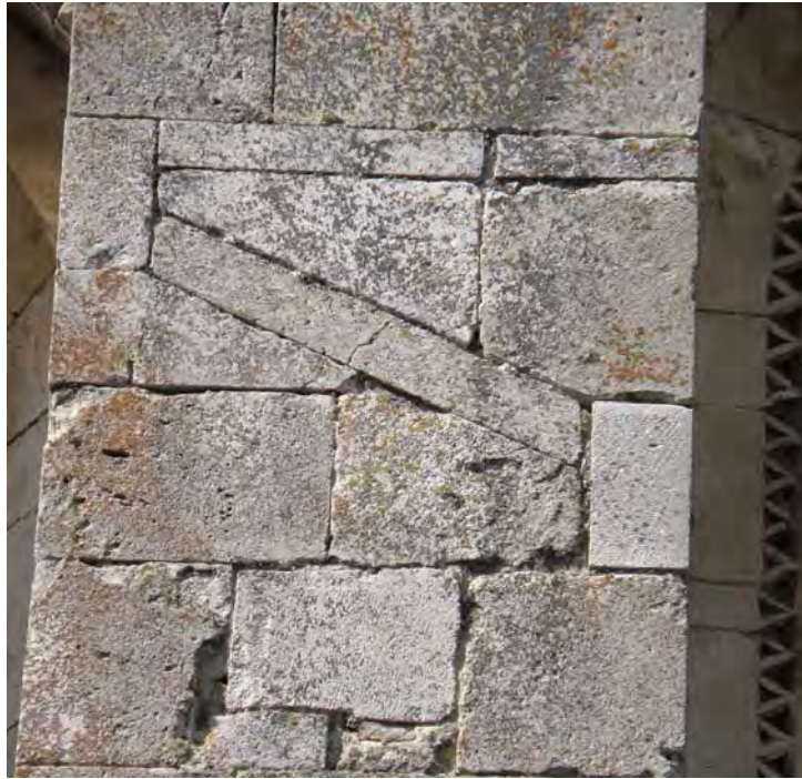
Fig. 215.- Las Huelgas. Iglesia abacial. Huella dejada por la cubierta de la derribada estancia adyacente a la capilla lateral sobre los dos contrafuertes del arranque meridional del ábside
