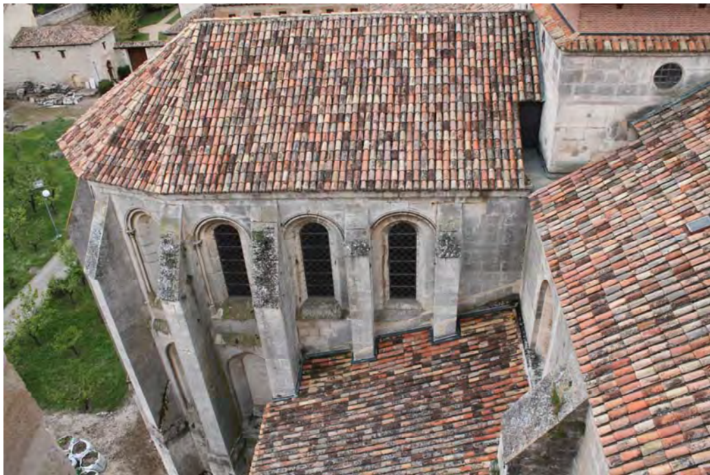
Fig. 201.- Las Huelgas. Iglesia abacial. Vista del flanco norte de la capilla mayor desde la torre, en la que se aprecian los contrafuertes que la jalonan y la huella dejada por la antigua cubierta de las capillas laterales
