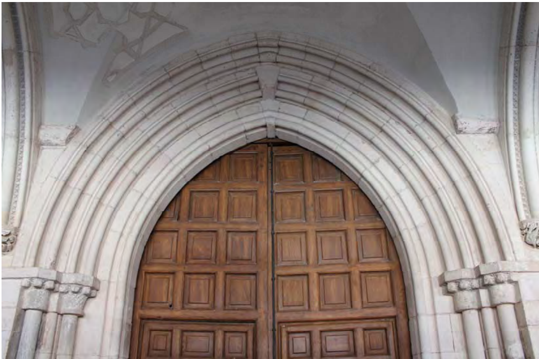
Fig. 592.- Las Huelgas. Claustro de San Fernando. Portada del refectorio, que interrumpe la imposta que recorre los muros perimetrales
