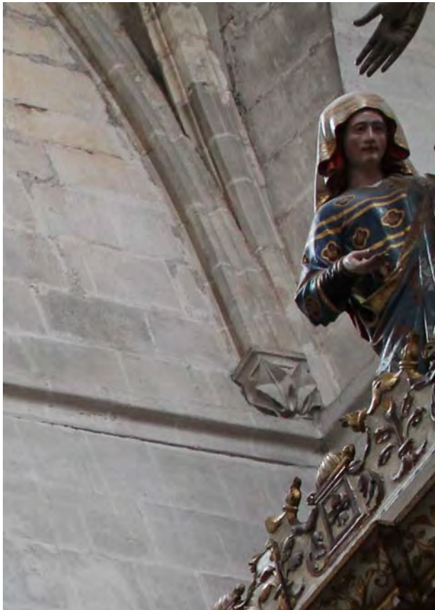
Fig. 559.- Las Huelgas. Iglesia abacial. Detalle del arranque del abovedamiento del tramo oriental de la nave central, con los nervios diagonales y los arcos formeros ciegos sin enjarjar
