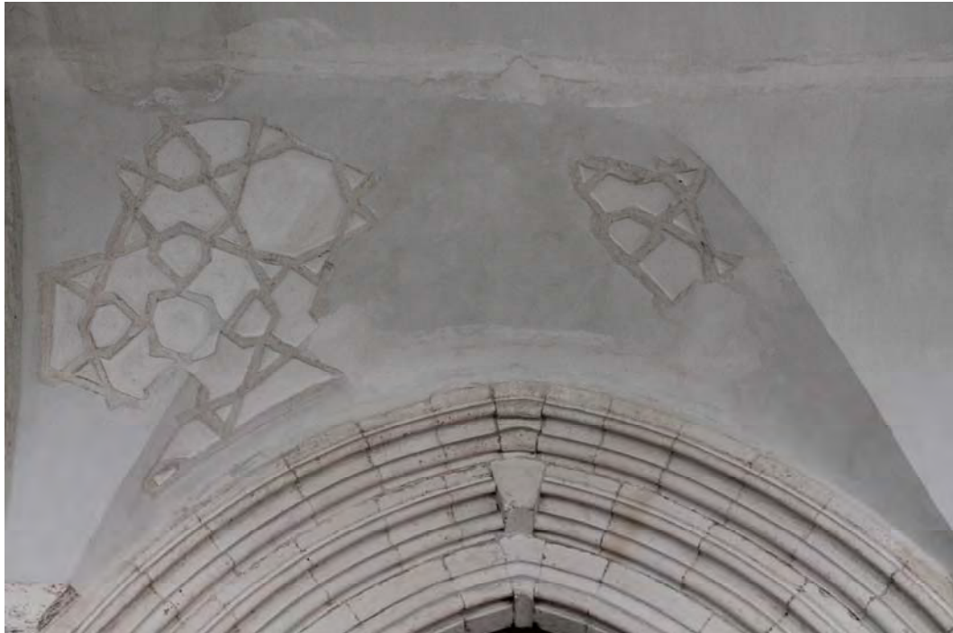
Fig. 590.- Las Huelgas. Claustro de San Fernando. Tramo de la bóveda de la panda meridional correspondiente con la puerta del refectorio, en el que se ve cómo el perfil de medio punto de la primera se arista en la parte tocante al muro perimetral como consecuencia de la preexistente presencia de la segunda
