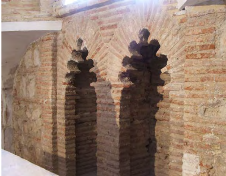
Fig. 125.- Las Huelgas. Capilla de la Asunción. Arcos y nichos excavados en el espesor del testero oriental
