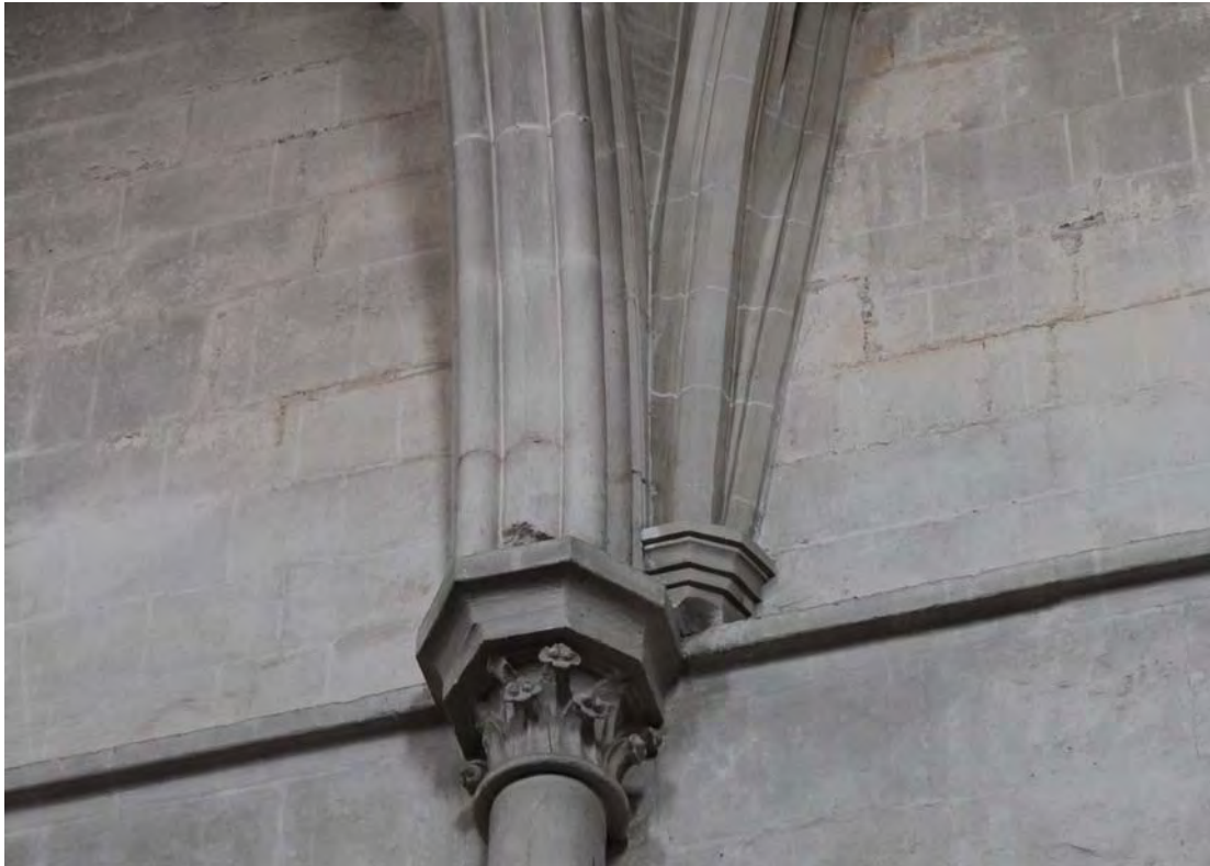
Fig. 558.- Las Huelgas. Iglesia abacial. Nervios diagonales de una de las bóvedas de la nave central, sin enjarjar con los arcos perpiaños
