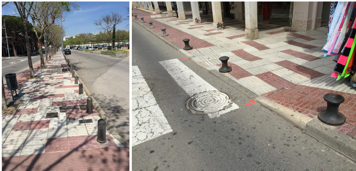
Imatge 24 i 25 : INCOMPLIMENT TIPOLOGIA DE PILONES AVINGUDA DOCTOR FLEMING i CARRER MIRARMAR
