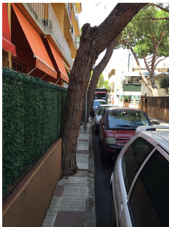
Imatge 1 : Manca accessibilitat al carrer NOSTRA SENYORA DE FANALS (CNSF02P) Font : pròpia.
