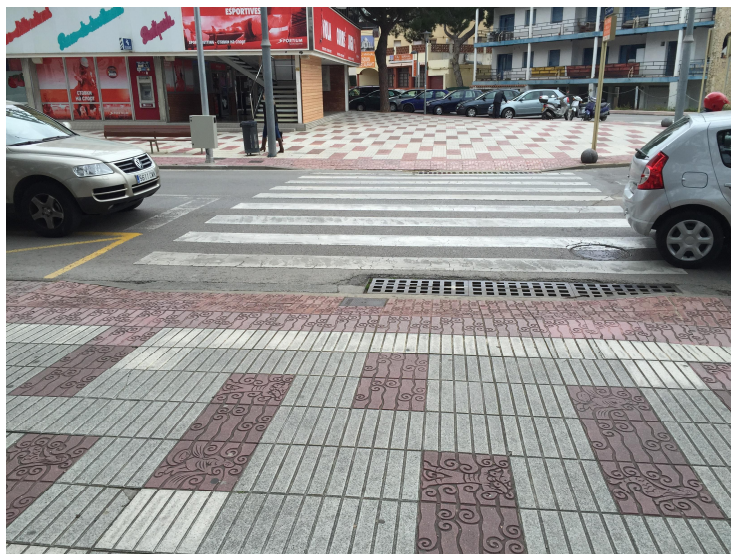
Imatge 19 : EXISTÈNCIA EMBORNAL AL PAS DE VIANANTS AV SÀGARÓ Font: Pròpia
