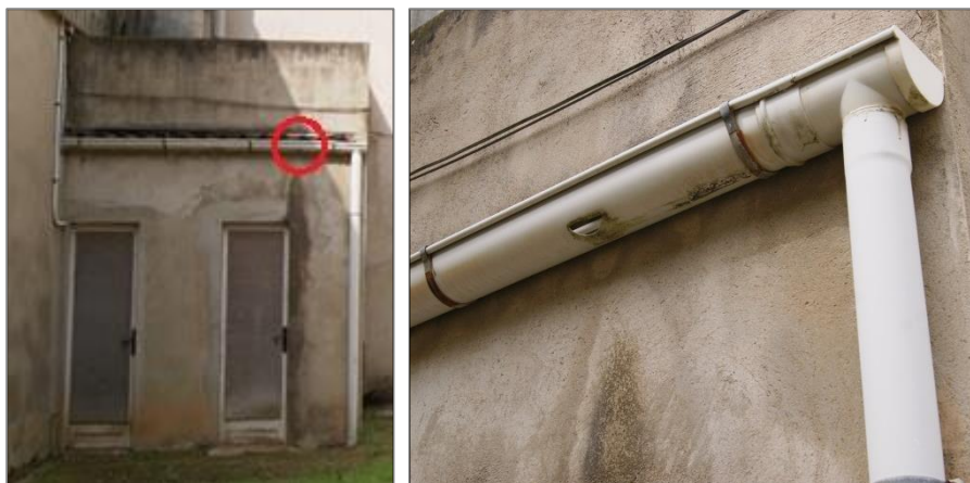
Figura 42. Caneló de recollida d'aigua trencat, situat en el tancament est de la construcció complementària a l'edifici 1
