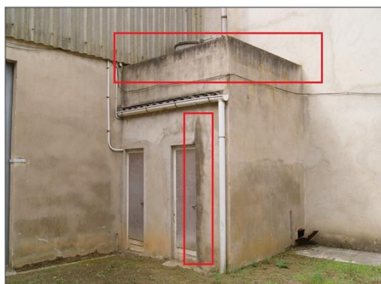
Figura 34. Brutícia per rentat diferencial en les parts superiors dels tancaments i sota la ruptura del canaló de la construcció complementària a l'edifici 1
