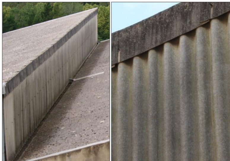
Figura 16. Brutícia en la part inferior de la vessant inclinada 17° i en l'ala llisa del cavallet
