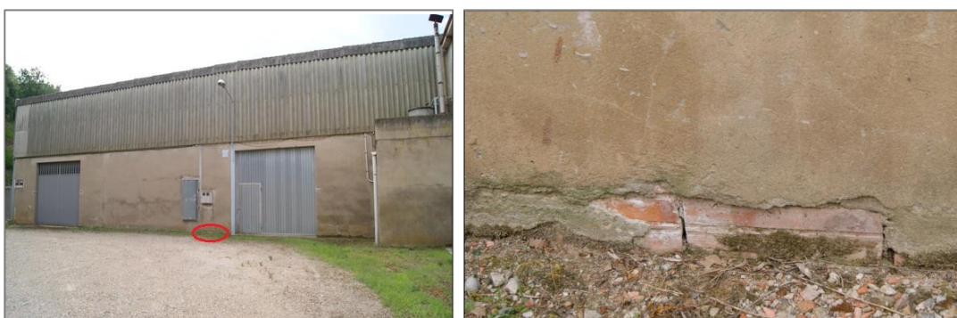
Figura 23. Despreniment del revestiment en la façana nord
