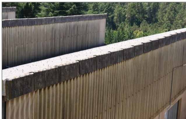
Figura 38. Brutícia per rentat diferencial en les plaques translúcides i cavallets de la coberta
