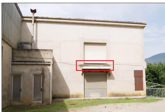
Figura 33. Brutícia per rentat diferencial sota la finestra de la façana est de l'edifici 1
