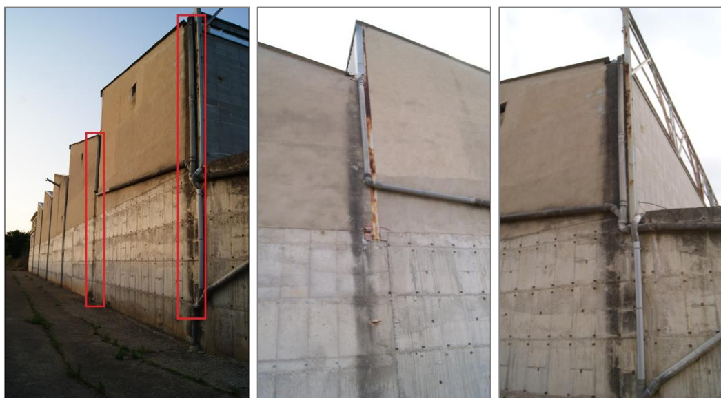
Figura 31. Brutícia per rentat diferencial en la zona del tancament situada sota les canals de les dos dents de serra més allunyades de la façana nord de la nau industrial
