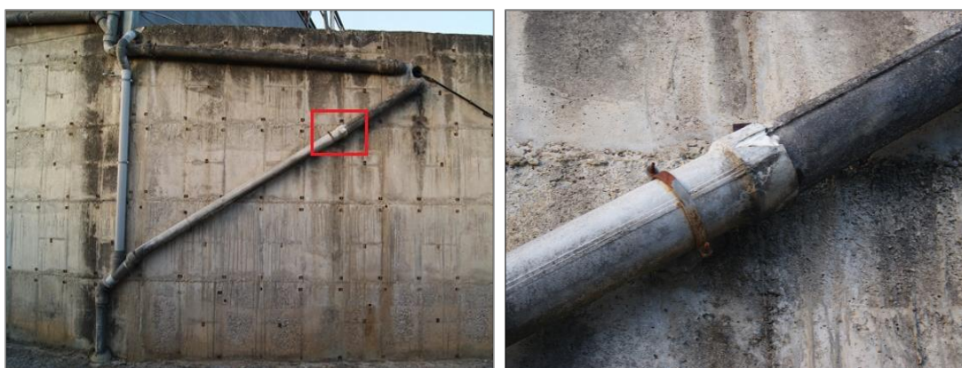
Figura 45. Exemplificació d'una ruptura de la baixant, brutícia superficial, i oxidació de la fixació, en la façana oest de la nau industrial
