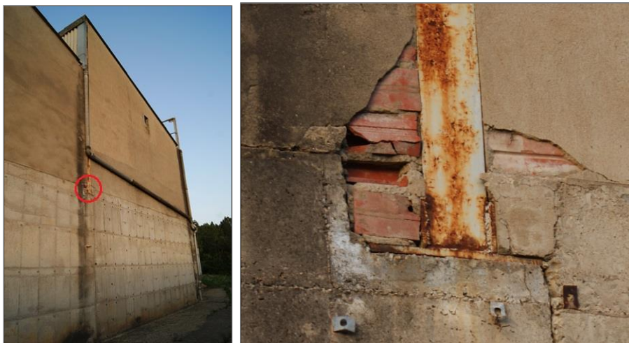
Figura 20. Ruptura A del tancament de façana oest de la nau industrial
