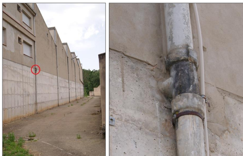
Figura 44. Baixant de recollida d'aigües pluvials trencada en la façana oest de la nau industrial.
