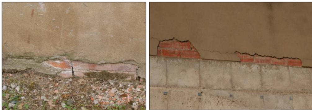
Figura 3. Exemplificació de despreniment de revestiment de façana en la nau industrial
