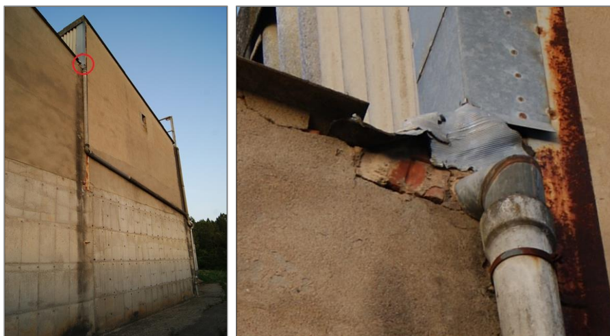
Figura 21. Ruptura B del tancament de façana oest de la nau industrial
