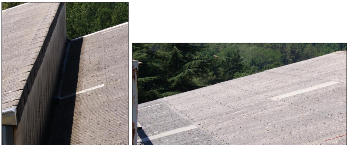
Figura 18. Tela asfàltica en les plaques de fibrociment de la coberta de la nau industrial.
