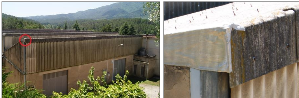
Figura 46. Presència de fongs en l'extrem est de la façana nord
