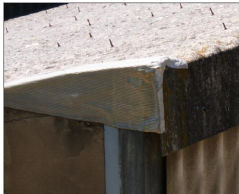
Figura 17. Presència d'organismes en l'ala llisa del cavallet situat a la façana nord de la nau industrial
