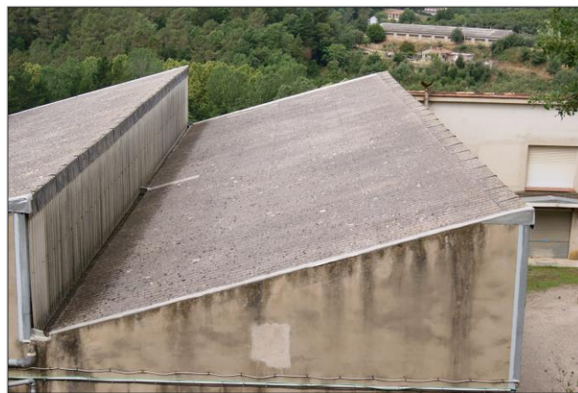
Figura 7. Presència de rentat diferencial en la façana est de la nau industrial
