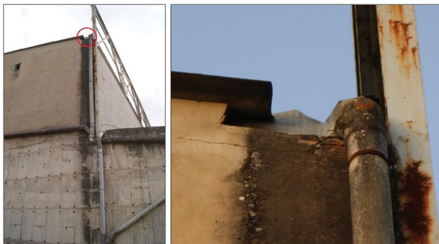
Figura 22. Ruptura C del tancament de façana oest de la nau industrial
