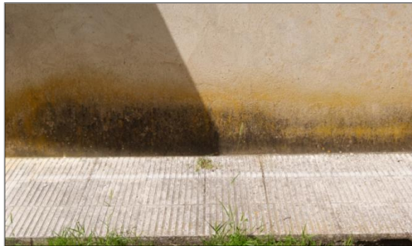
Figura 8. Presència de fongs en part inferior de la façana est de l'edifici 1
