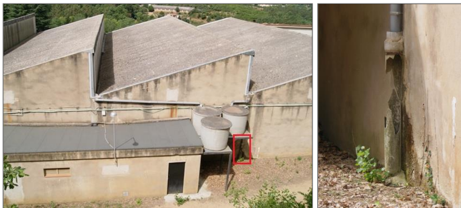
Figura 43. Baixant de recollida d'aigües pluvials trencada, situada en la façana est de la nau industrial
