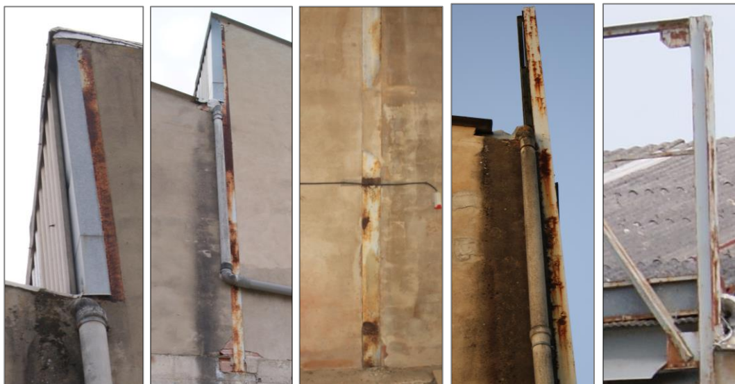
Figura 39. Pilars oxidats. Ordenats de esquerre a dreta (pilar 3D, pilar 2D des de l'exterior, pilar 2D des de l'interior, pilar 1D i pilar 13A)
