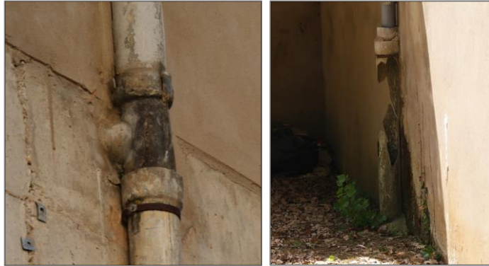
Figura 15. Exemplificació de ruptures en les baixants de recollida d'aigües pluvials de la nau industrial
