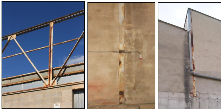
Figura 12. Exemple d'oxidació en l'encavallada Warren i pilars de la nau industrial
