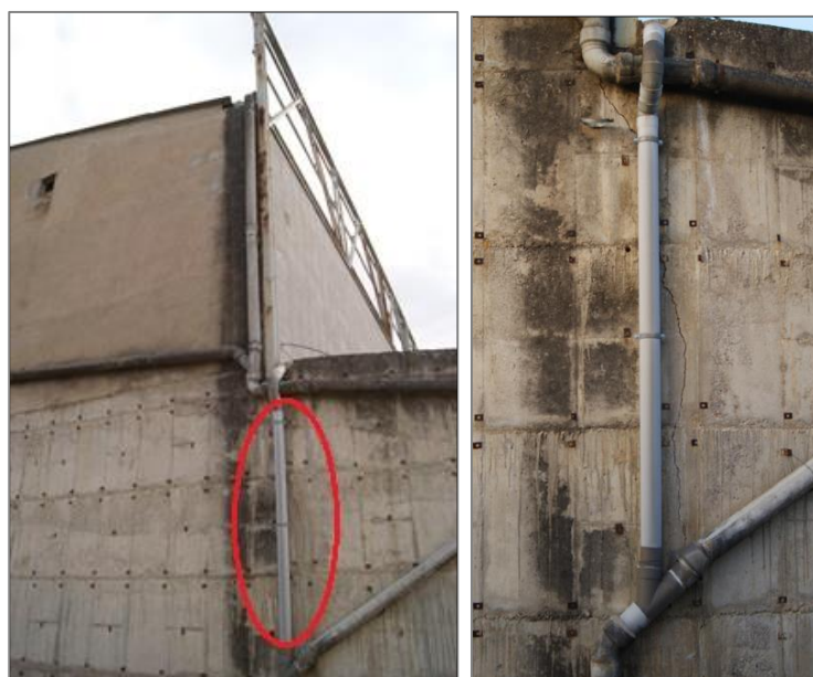
Figura 28. Esquerda D en la façana oest de la nau industrial
