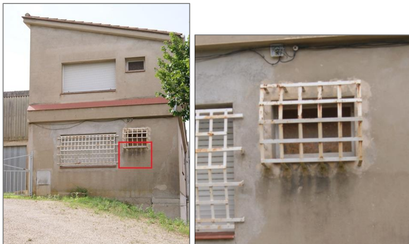
Figura 32. Brutícia per rentat diferencial sota la finestra del pis inferior de la façana nord de l'edifici 1
