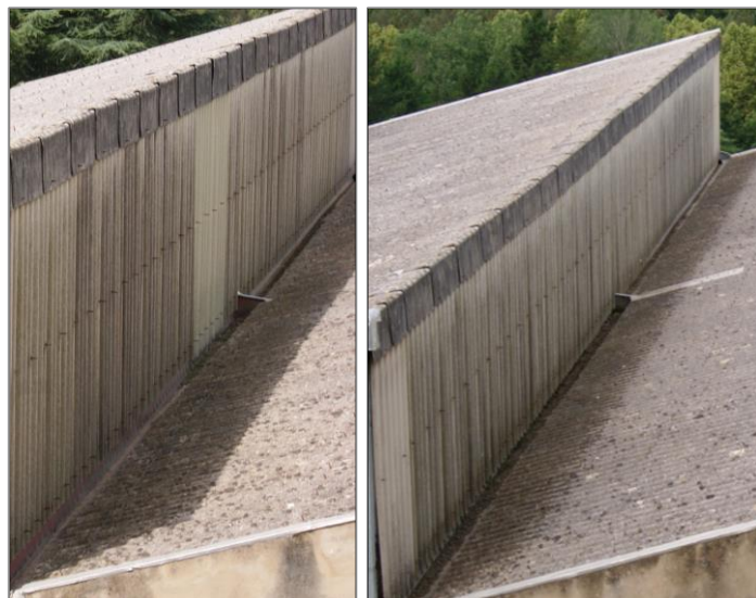
Figura 10. Brutícia en les plaques translúcides del tancament vertical de la dent de serra
