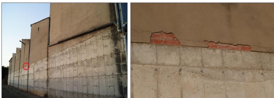
Figura 24. Despreniment del revestiment en la façana oest
