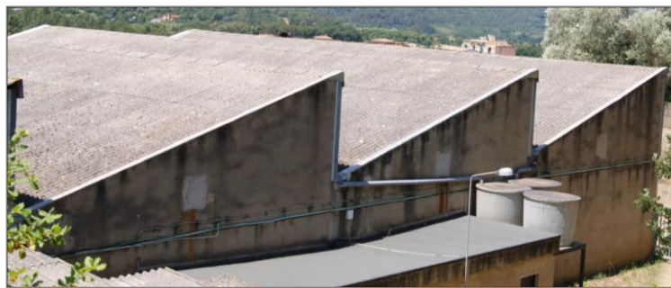
Figura 29. Brutícia per rentat diferencial en les tres dents de serra de la façana est més properes a la façana nord de la nau industrial
