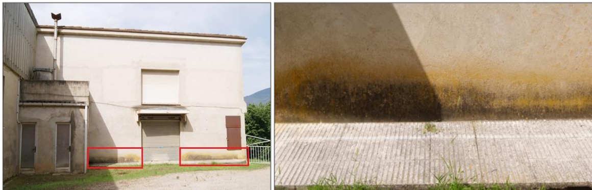
Figura 35. Presència de fongs en la façana est de l'edifici 1
