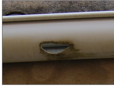
Figura 14. Ruptura del canaló de la construcció complementària a l'edifici 1
