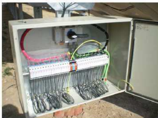
Figura 23 Caixa de connexió de grup
