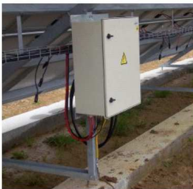
Figura 29 Caixa de connexió primer nivell
