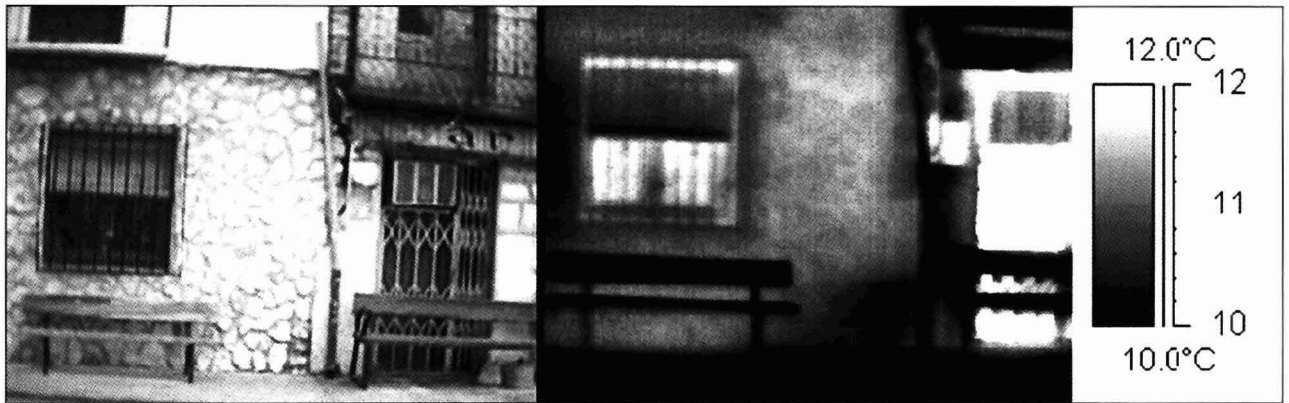
Figura 5.- Vivienda rural. El canalón de desagüe se ha partido y las aguas de lluvia caen directamente al suelo, se ha formado una zona húmeda en la parte inferior del muro que aparece como una zona fría en la imagen termográfica. Tomada al amanecer.
