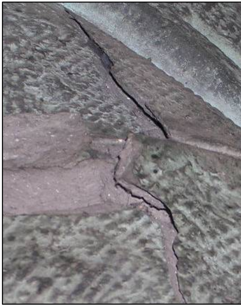
FIG 23: A l'esquerra es mostren les fissures verticals.
