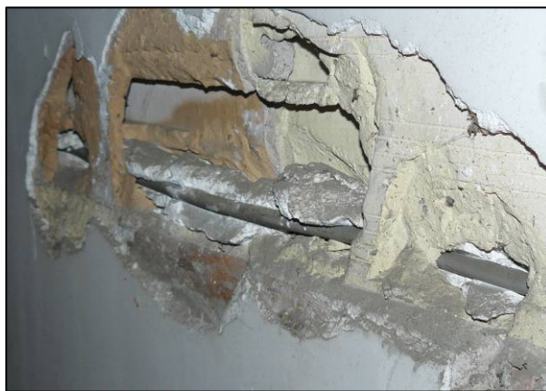
FIG 12: A dalt, trencament de peces ceràmiques que conformen la paret de tancament del campanar. La ruptura es situa al voltant de les instal·lacions.
