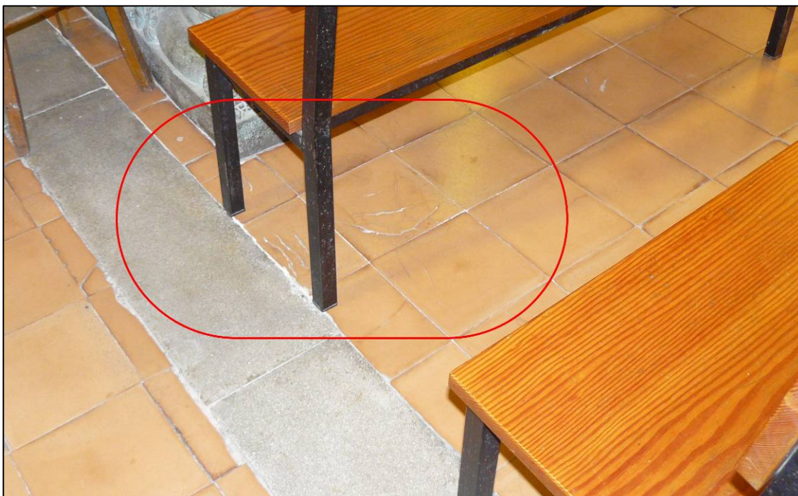
FIG 11: Paviment, Localització 17 i 18 en els plànols
