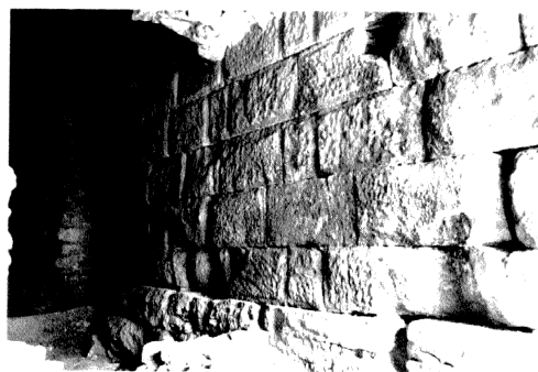
Figura 3.—Cara norte de la torre romana de Gironella. Las hiladas inferiores corresponden a la cimentación tardo-republicana y son de piedra caliza; las superiores con evidencias de almohadillado, de piedra arenisca corresponden a las murallas bajo-imperiales. En este sector hay que situar el portal de Levante (cliché J. M. Nolla).
