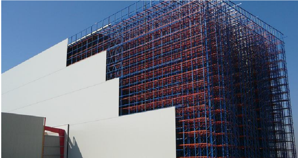
Figura 1.1 Aplicació dels panells Huurre al magatzem robotitzat de CocaCola de València (Font: Huurre Iberica S.A.).
