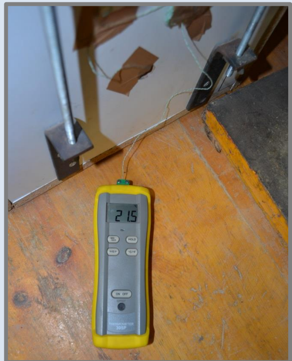
Connexió del lector a les sondes.
