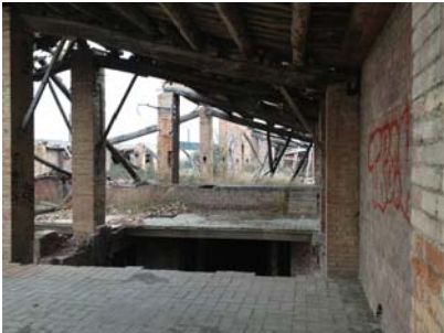
Fotografia de la planta primera on es pot observar l'actual mal estat de les estructures de coberta de l'edifici.
