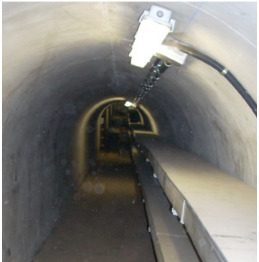
La galeria de serveis de Montilivi.
