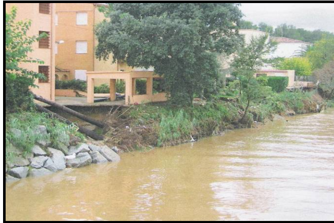
Foto 21.- Riera de Calonge. Vista de l'erosió del marge esquerre, des del pont del Carrer de Conrad Vilar aigua amunt
