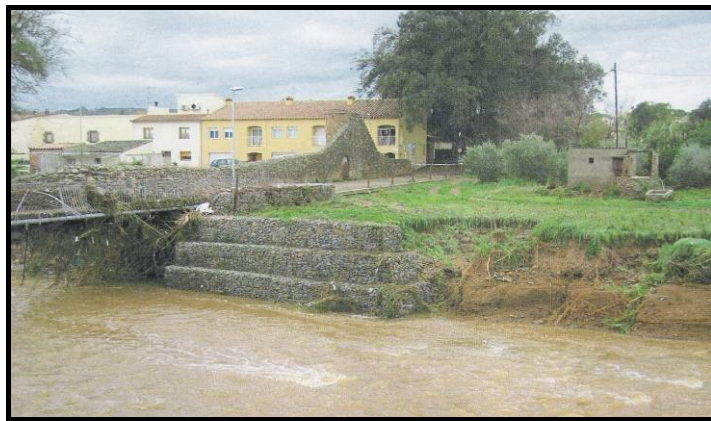
Foto 1 .- Riu Rifred. Erosió del marge dret en la transició de protecció amb gabions, just aigua amunt de la passarel·la peatonal del Camí Fondo
