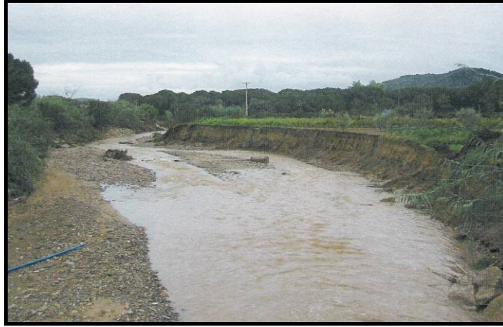
Foto 5.- Riu Rifred. Vista cap a aigua avall des del pont de la carretera de Romanyà (erosió del marge esquerre)
