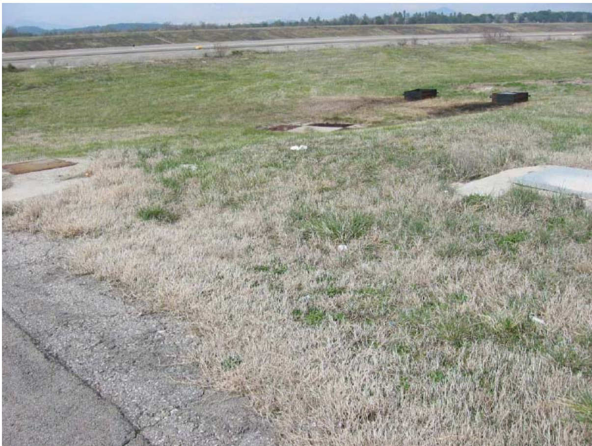
Figura 17. A l'esquerra, arqueta d'abalisament. Al centre, arqueta de xarxa de pluvials. A la dreta, arqueta elèctrica a 3000 V.
