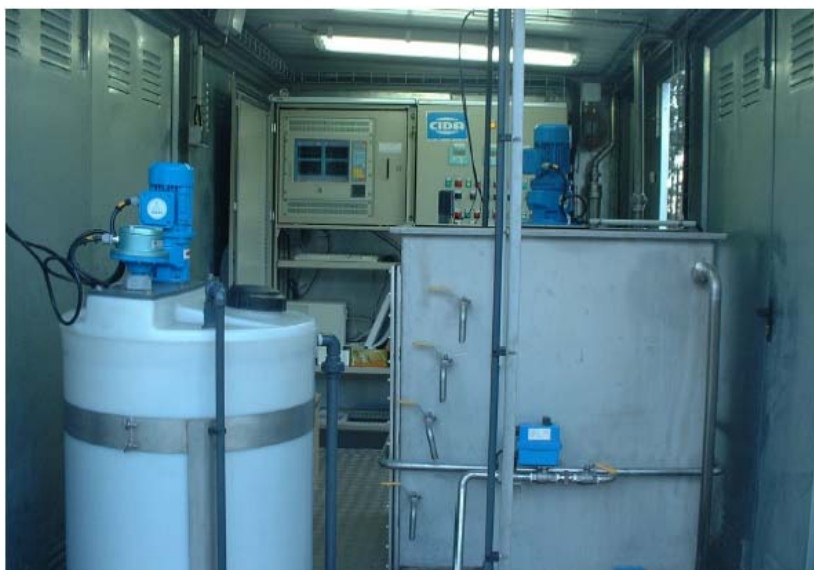
Figura 3. Planta pilot SBR emplaçada a l'EDAR del Terri
