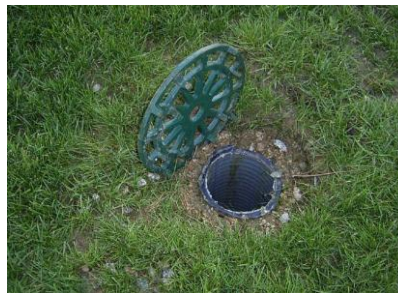
Imatge 23 :Tub drenant en carrer. Font: Jornada_Greenkeepers_Mas_Badia_Nov_04_07.
