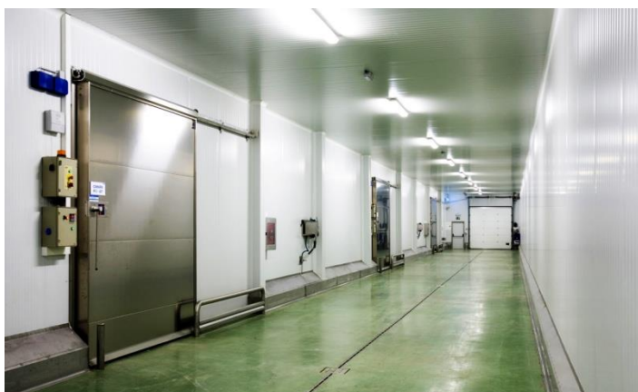
Figura 3-3. Exemple de cambres frigorífiques
