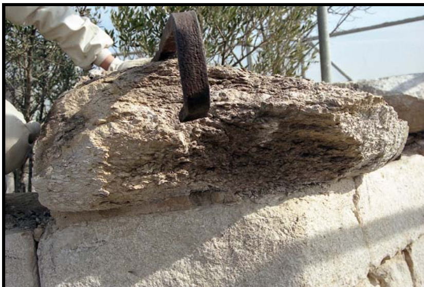
FOTOGRAFIA Nº30: DEGRADACIÓ DE LA PEDRA
